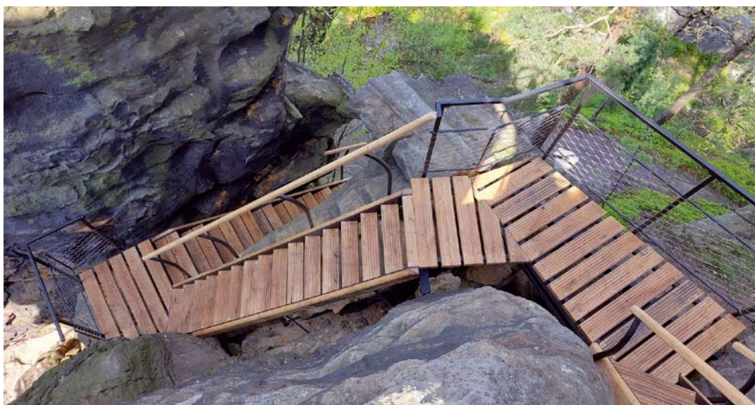
Výstup na vrcholy Jetřichovických vyhlídek nyní návštěvníkům usnadní schodiště, která překlenují opotřeбенé pískovcové schody.
